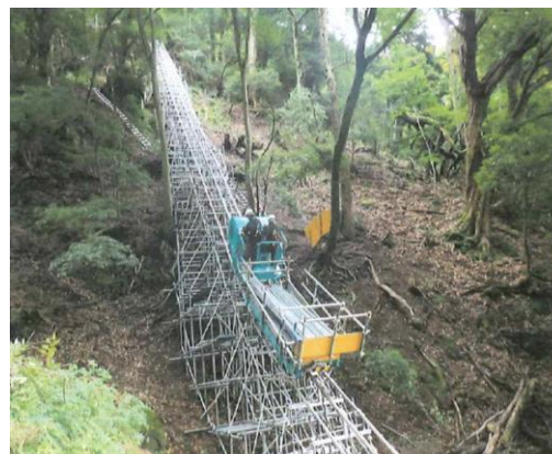
工事用モノレール
