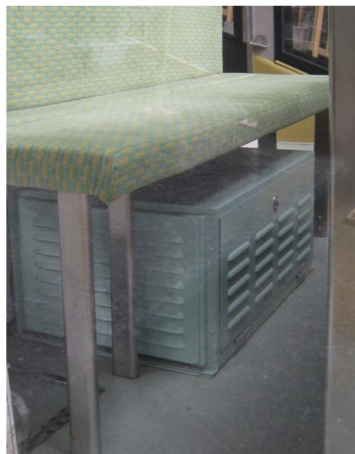
リチウムイオン蓄電池
