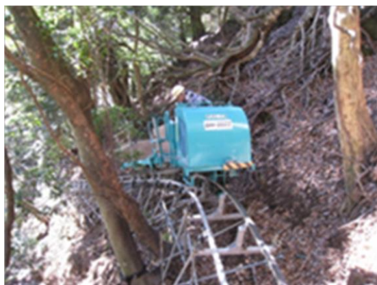
工事用モノレール
