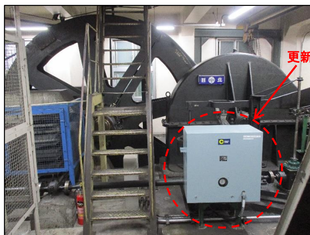
非常制動機油圧ユニット
